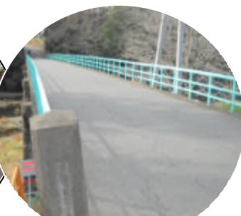
老朽化した清川橋
