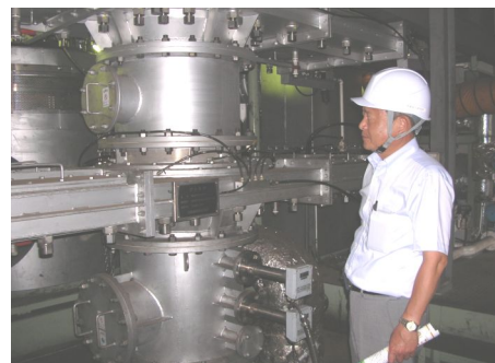
滝沢 私は、秩父市上吉田の木質バイオマス発電所を視察してきました。
